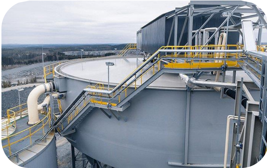
Figura 1.3 Sistema de espesamiento de relave
