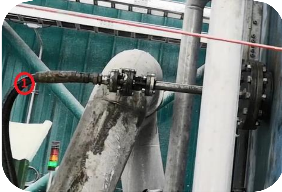
Figura 3.3 Vista lateral del canal de soplado del filtro prensa
