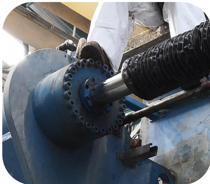
Figura 3.17 Evidencia de fuga de aceite en uno de los cilindros hidráulicos Fuente: Cesar Miranda. Visita a planta de procesamiento de mineral [31]
