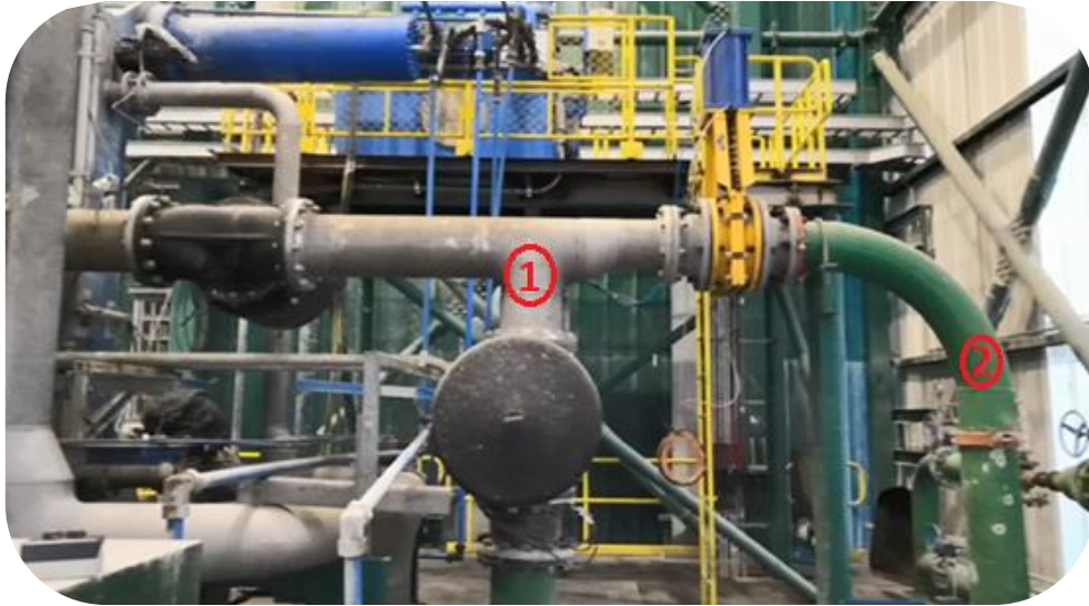
Figura 3.1 Vista lateral del canal de alimentación (2) y retorno de relave sobrante (1) Fuente: Cesar Miranda. Visita a planta de procesamiento de mineral [31]
