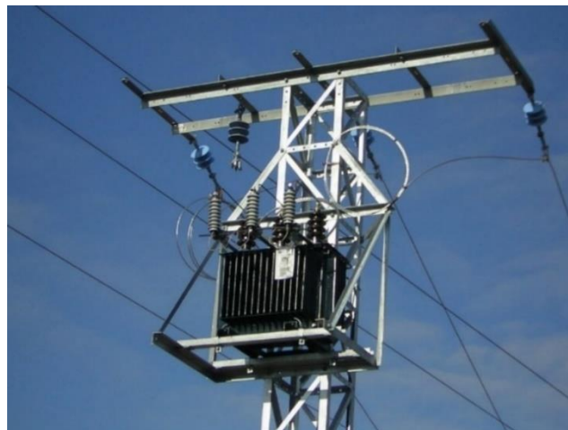
Figura 1.6 Centro de transformación aéreo
