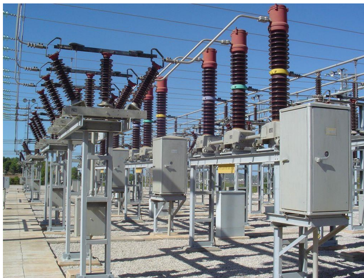
Figura 1.4 Subestación Eléctrica Fuente: Petróleo Mundo [20]
