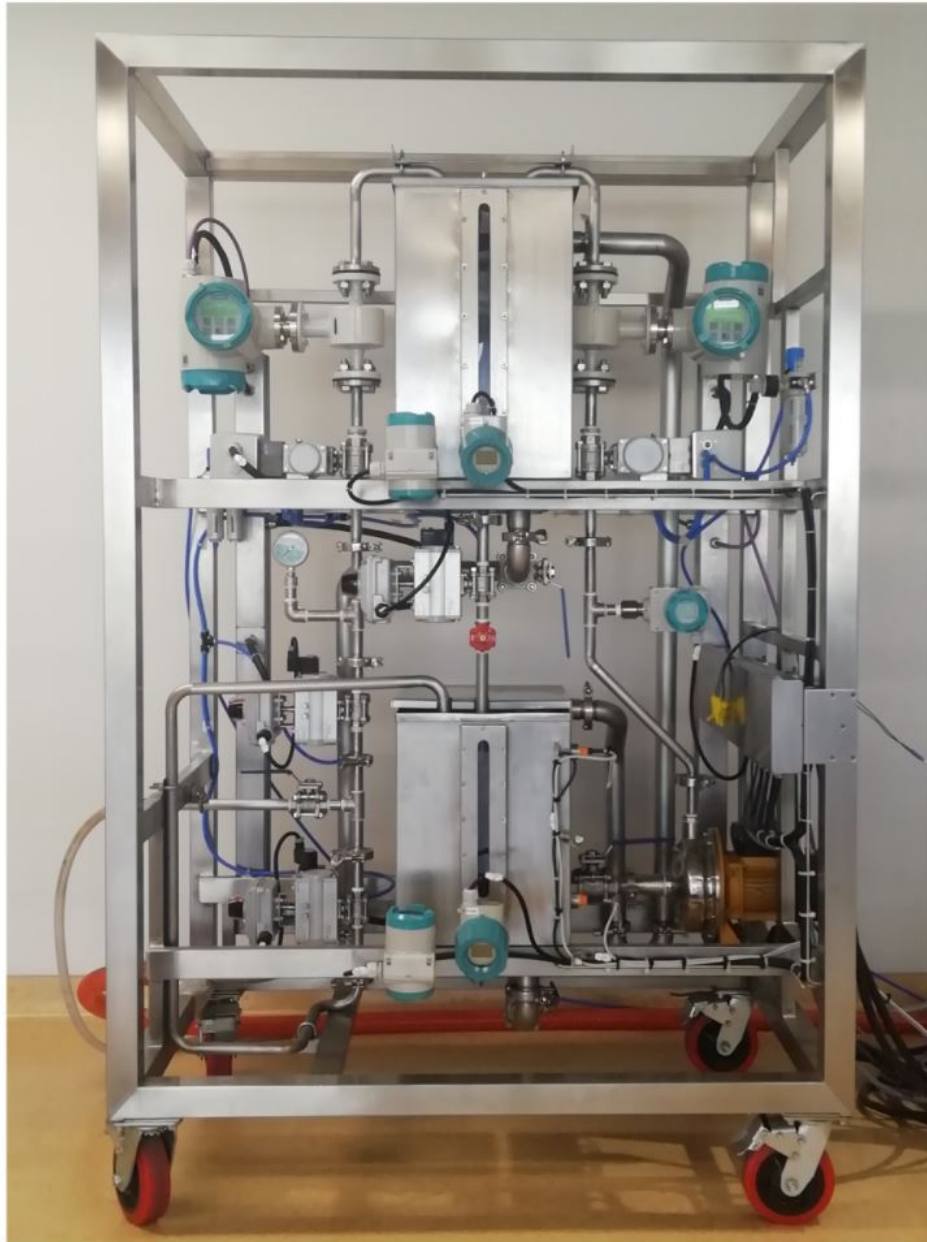
FIGURA 2.8: Planta industrial multipropósito para control e instrumentación [23]
