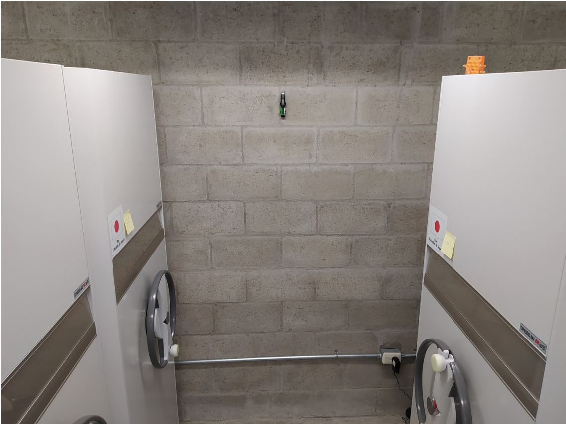
FIGURA 5.4: Nodo N1 colocado a un nivel alto para una conexión exitosa.
