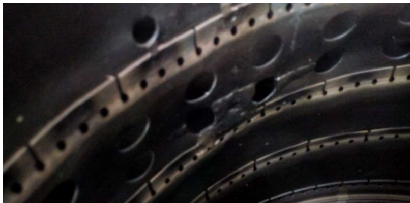
Fig. 3.12. Fotografía de soldadura de rajadura en los hoyos de dilución terciarios en el anillo interno de la cámara de combustión del motor AI-20D-5
