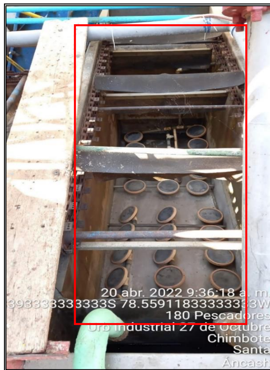
Figura 2.4. Tanque de trampa de grasa.[16]
