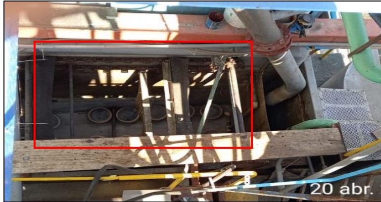
Figura 2.5. Vista superior de tanque de trampa de grasa.[16]
