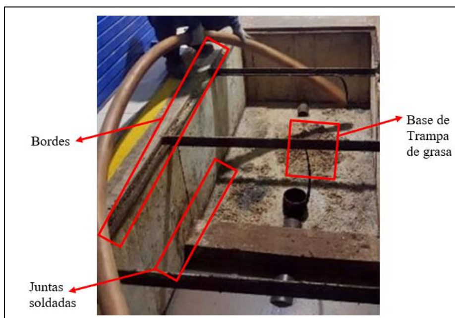
Figura 1.4. Zonas frecuentes corroídas una trampa de grasa.[22]
