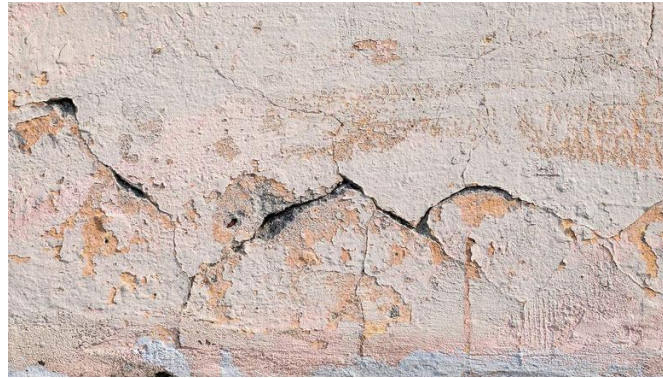
Figura 2: Ejemplo de descascaramiento y grietas [7]
