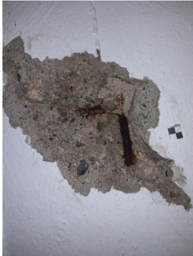
Figura 22. Descascaramiento en una losa
